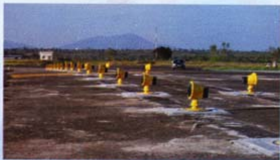
Các thiết bị đèn hiệu sân bay do ATTECH sản xuất được lắp đặt tại các sân bay
